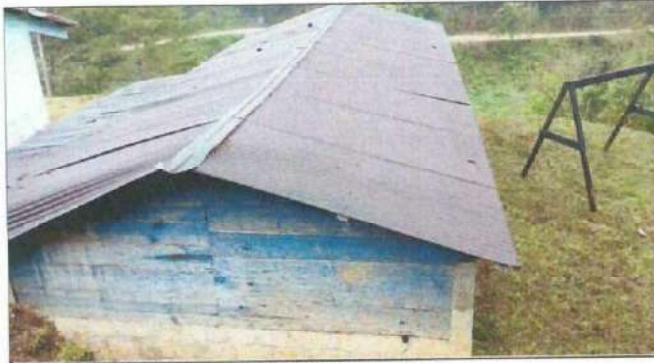
Foto 4: Sustituir la madera por block. AULA No.2
